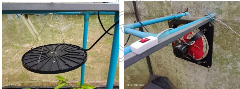
ภาพที่ 5 แสดงการติดตั้งชุดหลอดไฟปลุกต้นไม้และการติดตั้งพัดลมระบายอากาศ
