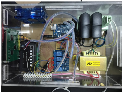
ภาพที่ 4 ระบบควบคุม
